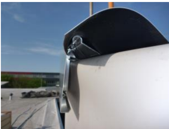
Abdeckung mit Folienunterzug bis zur Fassade und somit ohne Möglichkeit für Fledermäuse und den Mauersegler auf den Drenpel zu gelangen. Zudem sind Folien i.d.R. zu glatt, um den Krallen der Vögel oder Fledermäuse Halt zu bieten.
