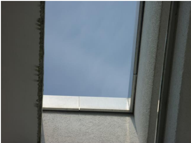
Unterschiedlicher Abstand der Blechabdeckung zur Fassade. Mauersegler und Fledermäuse konnten Unter das Blech einfliegen und auf die Mauerkrone, den Sims gelangen.
