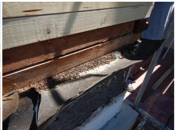
Kot auf Dachbahn. Hangplatzbereich auf Bitumenbahn sowie am Holz des Aufbaus.
