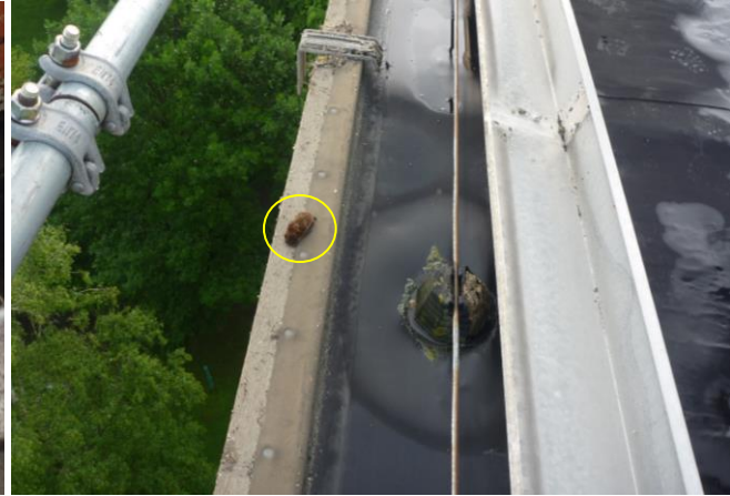
Abendsegler auf dem Sims. Gut erkennbar ist das bündig zur Fasse abschließende Holzbrett, das nur zur Hälfte mit Folie überspannt ist.
